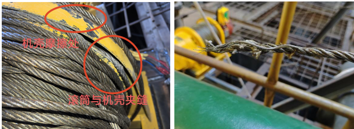
图 3 北侧卷扬机及钢丝绳断裂绳头
